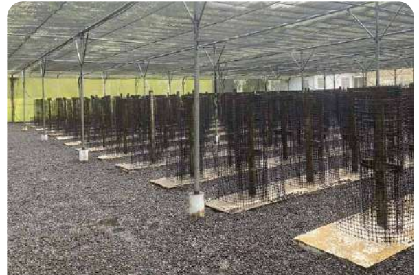
Tuteurs innovants mis en place avec la dalle en béton au sol
